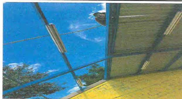
Foto 4: Aulas y baños sin láminas
