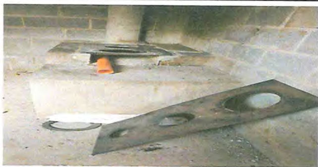
Foto 1: en proceso el cambio de plancha de metal de 3 hornillas.
